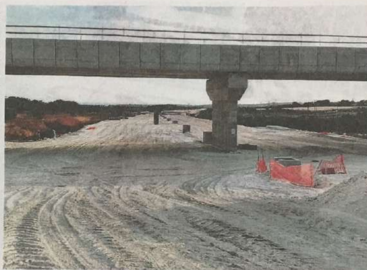
Un cantiere chiuso sulla Modica-Rosolini per il quale le imprese reclamano il pagamento dei Sal maturati
