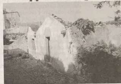
EDIFICI PERICOLANTI. E' una delle costanti nelle aree più gettonate del centro storico
