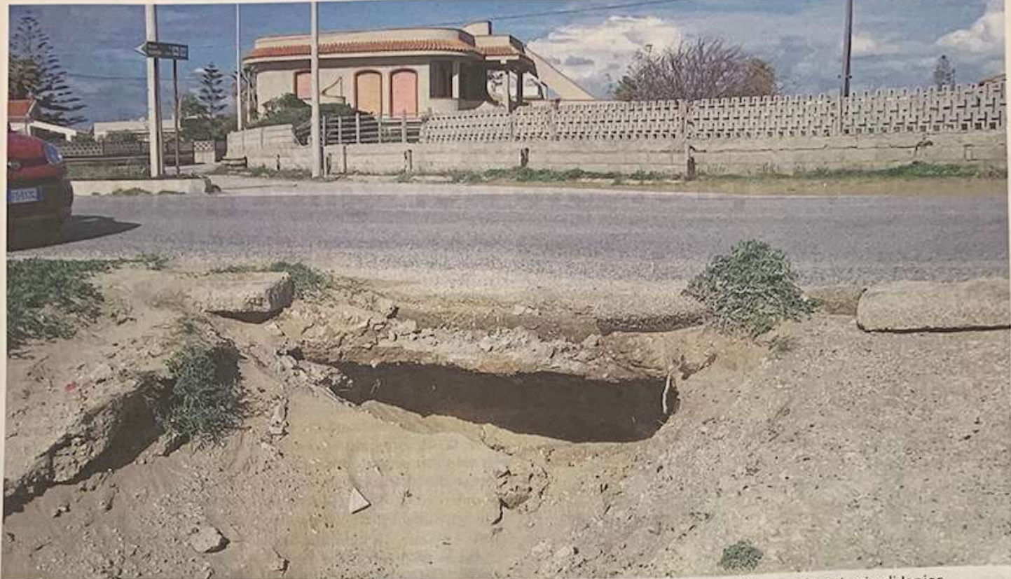
Erosione. Un tratto franato lungo la strada provinciale 67 che collega Santa Maria del Focallo a Marina Marza, nel territorio di Ispica
