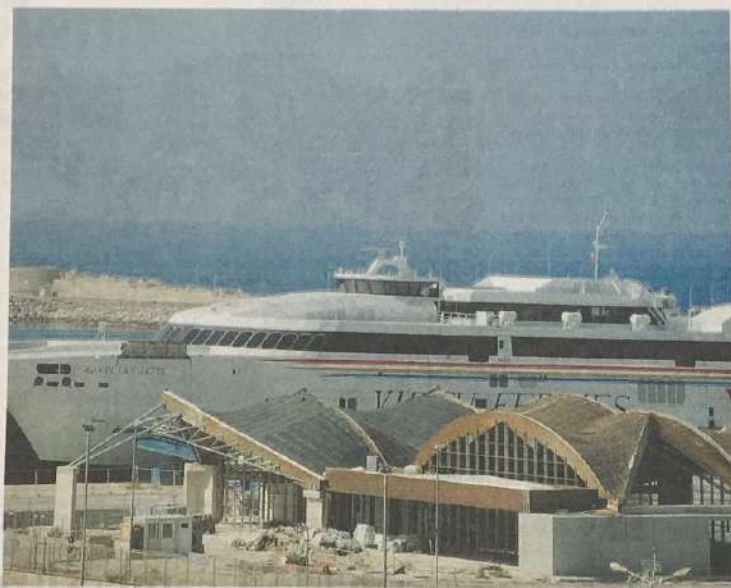
La stazione dei passeggeri al porto di Pozzallo in via di completamento
