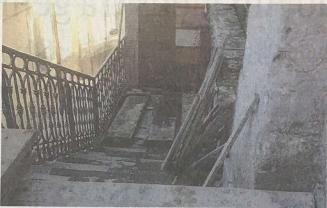
I LAVORI TUTTORA IN CORSO AL DUOMO DI SAN GIORGIO A IBLA
