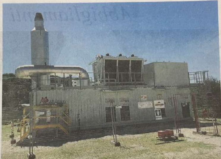
Un'immagine del co-generatore FOTO BOCCHIERI
