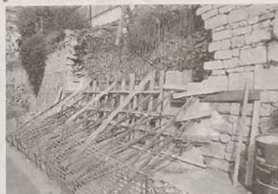
VIA PULINO. Il muro di contenimento dei lavori in via Pulino dopo la frana dovuta al maltempo
